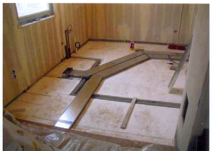
Obr. 13: Podlahové rozvody teplovzdušného vytápění
