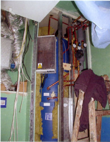
Obr. 10: Bivalentní nádoba IZT slouží jako zásobník tepla (potřebné teplo je získáváno prostřednictvím solárních panelů, popř. elektrických spirál)
