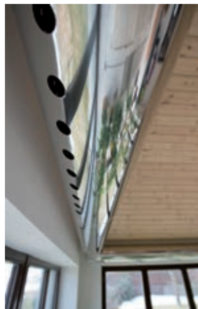
Rozvod vzduchu po bazénu zajišťuje provětrávání všech rohů a koutů
