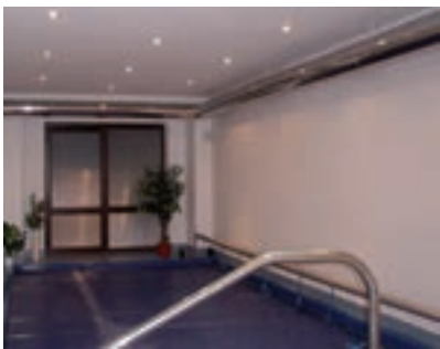
Společně s odváděným vzduchem jsou odváděny i výpary bazénové chemie a vlhkost
