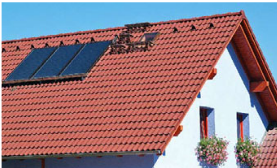
Dominantním prvkem na jižní straně střechy je trojice plochých solárních kolektorů. Pokud by se použily ploché kolektory s vakuovou izolací, v porovnání s běžnými plochými kolektory by přinesly o 20–30 % vyšší energetický zisk a dvojnásobnou životnost (vše THERMOSOLAR Žiar nad Hronom)
