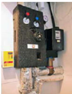
Solární systém má „řídící centrum“ v rohu přízemní koupelny
