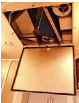
Srdce vzduchotechniky na stropě přízemní koupelny: centrální jednotka Duplex RB
