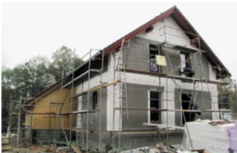
Zvenčí byly na místa spojů obvodových stěn dolepeny polystyrenové izolační desky a venkovní obálka byla poté opatřena finální omítkou
