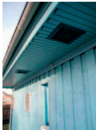
Větrací systém zakončený žaluziemi v dřevěném pohledu objektu
