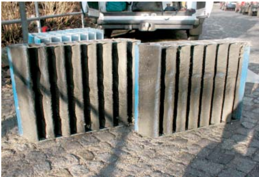
Tyto silně znečištěné součásti vzduchovodů sice nejsou z rodinného domu, ale je na nich dobře patrné, jak zanedbaná údržba promění zdraví prospěšné zařízení v opak
