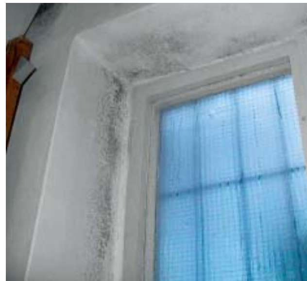
Plísně na špaletě okna. Standardní projev kombinace podchlazení povrchu okenního ostění a nevětraného prostoru kuchyně, který způsobí růst plísní
