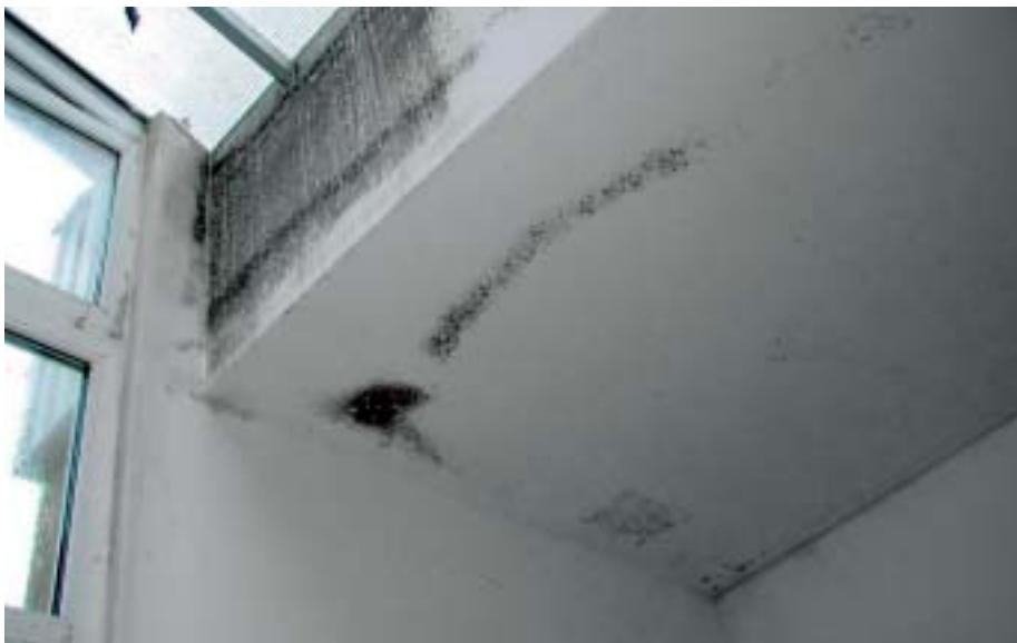
Masivní rozvoj plísní na vlhkém povrchu konstrukcí rodinného bazénu
