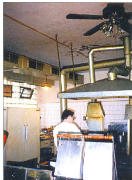
Obr. 1 – Příklad zcela nevhodné koncepce digestoře, špatně dimenzované, s „chladicí“ vrtulí u stropu.
