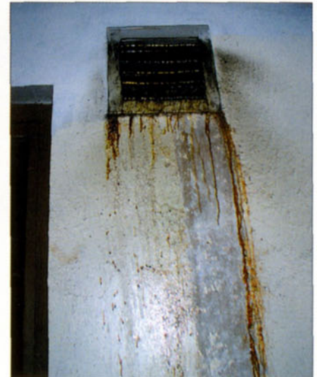
Obr. 4 – Následky svévolného odstranění tukových filtrů nad fritézou
