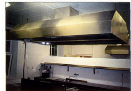
Obr. 5 – Bočně nezakryté digestoře (velkoplošné) se šora silně znečišťují usazenými aerosoly a prachem
