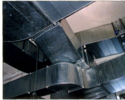
Obr. 3 – Vícevrstvé vzduchovody s křížením, které nelze čistit, navíc neizolované
