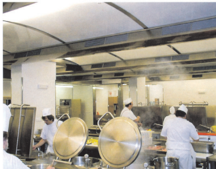
■ Stropy SKV zajišťují rovnoměrné celoplošné osvětlení difúzně rozptýleným světlem.
