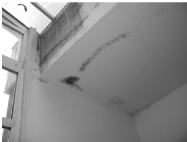
obr. 1 Plošná plíseň na stěně nevětraného bazénu
