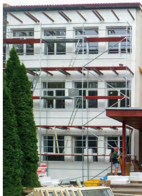
Rekonštrukcia budovy školy zahŕňala, okrem iného, zateplenie obvodového plášťa a výmenu okien
