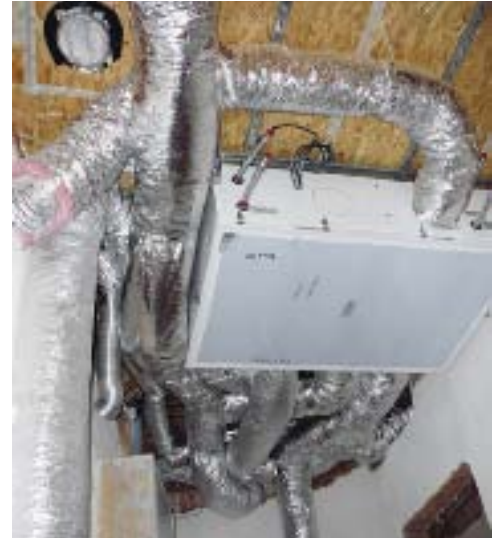
V technické místnosti je vzduchotechnická jednotka Atrea, která pomocí rekuperace a solankového výměníku ohřívá nebo chladí vzduch v domě
