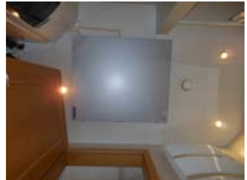
Tatáž vzduchotechnická jednotka s provedeným pohledem
