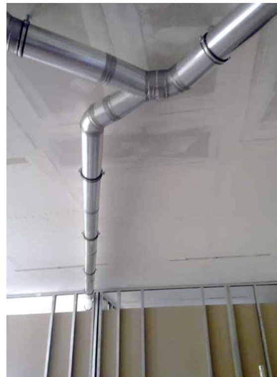
Vďaka zvyšovaniu cien energie je predpoklad relatívne rýchlej návratnosti nadobúdacích nákladov. Realizácia rozvodov v bytoch nie je taká náročná, ako sa na prvý pohľad môže zdať. Pripravujú sa aj ďalšie varianty rozvodov tak, aby sa užívateľ pri rekonštrukcii musel obmedziť na minimálnu možnú mieru. (foto: Atrea)
