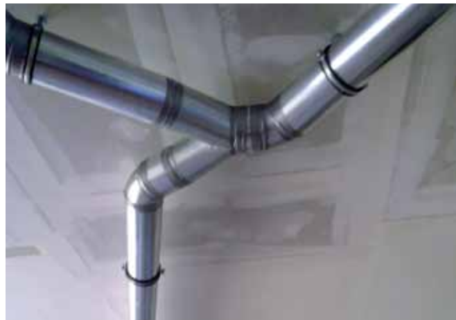
Tesné vzduchotechnické rozvody sú vedené pod stropom miestností. Sú zakryté podhľadom, ktorý zároveň znižuje strop a upravuje svetlú výšku miestnosti.
